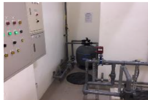
雨水回收儲存系統
